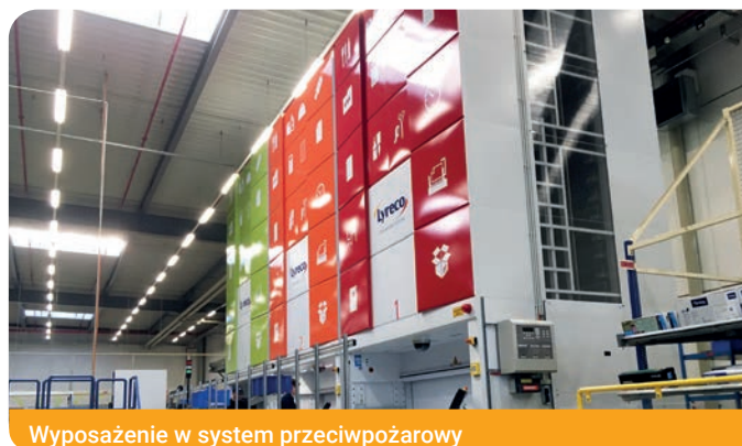
Wyposażenie w system przeciwpożarowy
