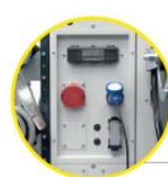
Agregat prądotwórczy 20 kVA, 3-fazowy
