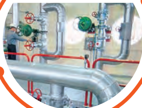
POMPY, NAWADNIANIE I WODOCIĄGI
