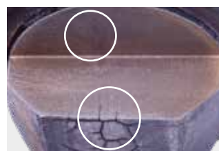
Pęknięcia w głąb Cracks in depth
