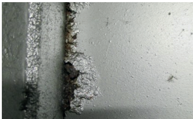
Korozja szczelinowa na obudowie. Postępujące rdzewienie podpowierzchniowe powoduje uszkodzenie powłoki (źródło: OBO Bettermann)
