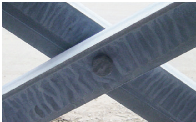
Lekka biała rdza na konstrukcji ocynkowanej ogniwo (źródło: Institut Feuerverzinken)
