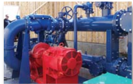
Pozioma stacja pomp
