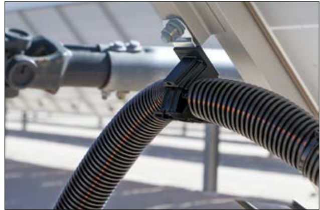
Zarządzanie przewodami na trackerach w instalacji fotowoltaicznej.
