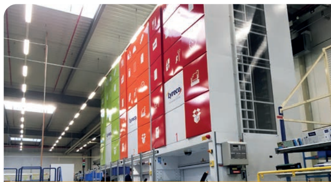
Wyposażenie w system przeciwpożarowy
