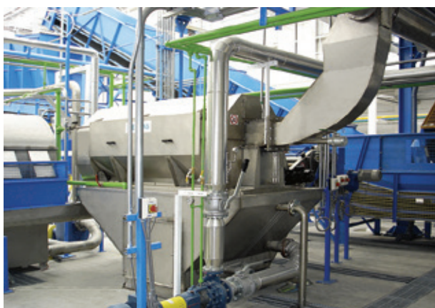
Filtrazione acqua Water filtration
