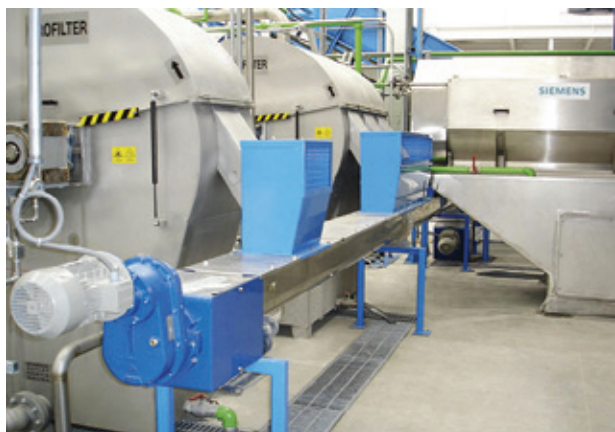
Filtrazione meccanica Mechanical filtration
