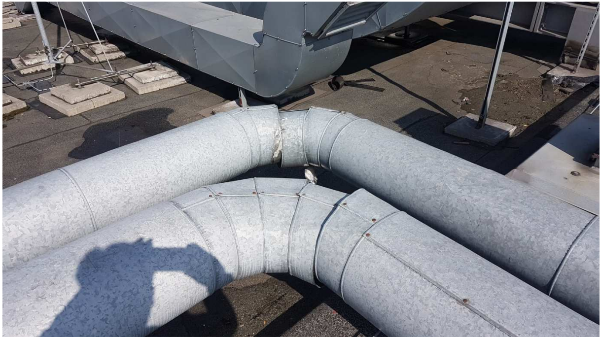
Wygląd uszkodzonej izolacji rurociągów ciepłowniczych
