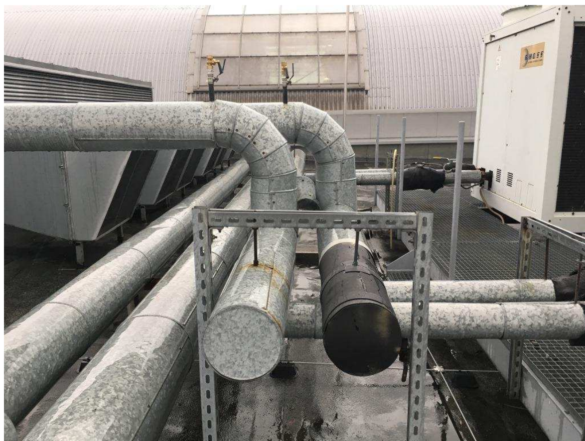
Widok kolektorów wody lodowej z agregatów RHOSS i podłączoną instalacją odbiorczą
